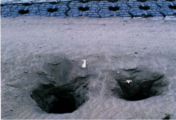
写真-4 砂浜表面から判別しやすい砂の吸出し痕跡
