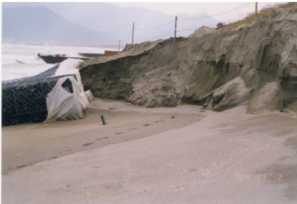
写真一 台風による海岸災害の例
